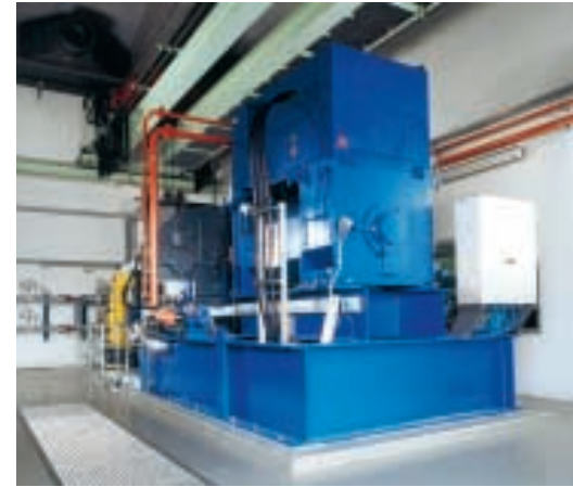
L'alternateur de 1800 kW él , devant la turbine de détente de gaz naturel
