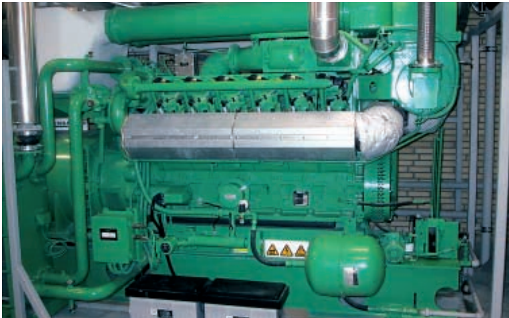
Moteur à gaz du CCF de 625 kW él , qui fournit la chaleur nécessaire au préchauffage du gaz naturel
