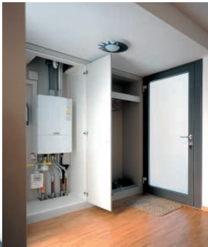
Chaque maison familiale possède sa propre chaudière murale modulaire à condensation à gaz, dans l'entrée, à l'intérieur d'un placard
