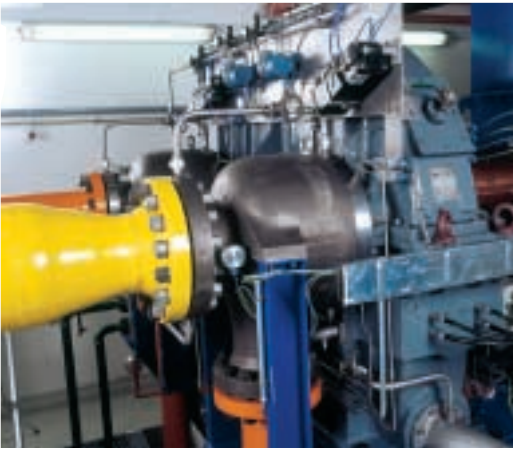
La turbine de détente
