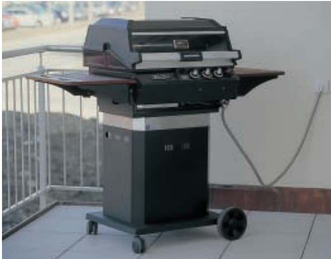
Prise gaz et grill à gaz naturel sur la terrasse de la cafétéria
