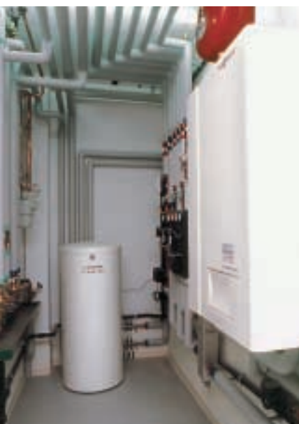
La chaudière à condensation à gaz module en continu de 11 à 44 kW; derrière, le chauffe-eau
